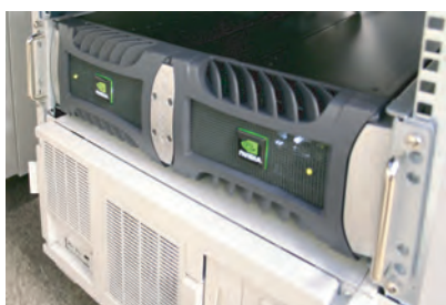
「Quadro Plex 2200 D2」を2台ラックに設置する。その下にはワークステーションの「NEC Express 56 X1」が設置されている。
